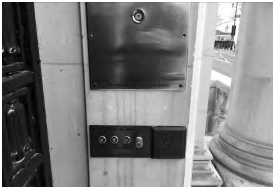
Figg. 8, 9 – Dettaglio delle pulsantiere ubicate a monte e a valle della scala che consentono l'arretramento della stessa e l'attivazione della piattaforma elevatrice (foto di Luigi Iannone, anno 2016).
